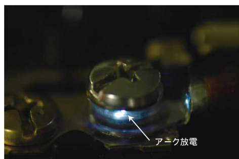
図1 ネジの緩みによって発火したアーク放電の例
